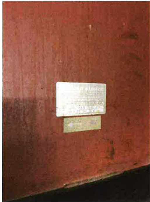
Photo 26: AHU fan tag
