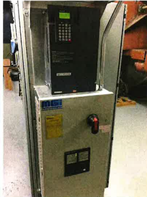
Photo 38: Return fan VFD
