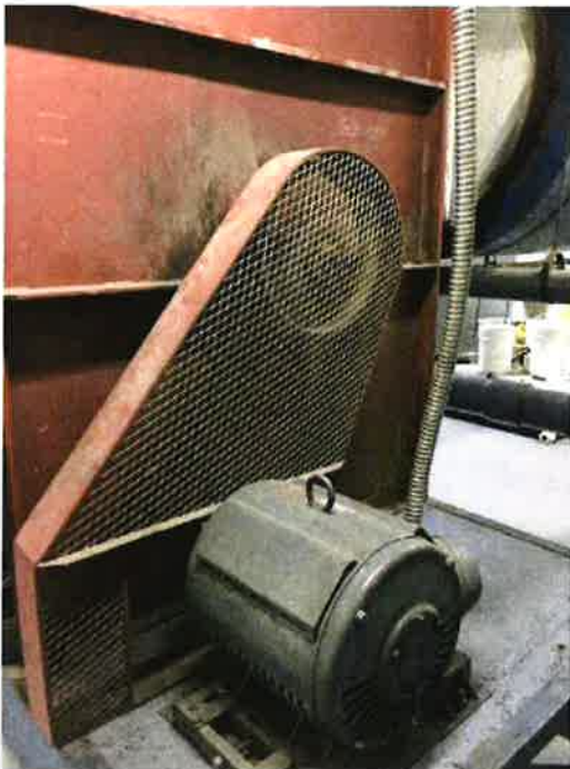
Photo 57: AHU1 supply fan
