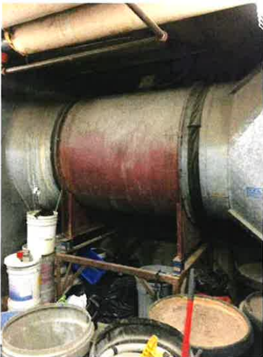
Photo 99: Parkade exhaust fan
