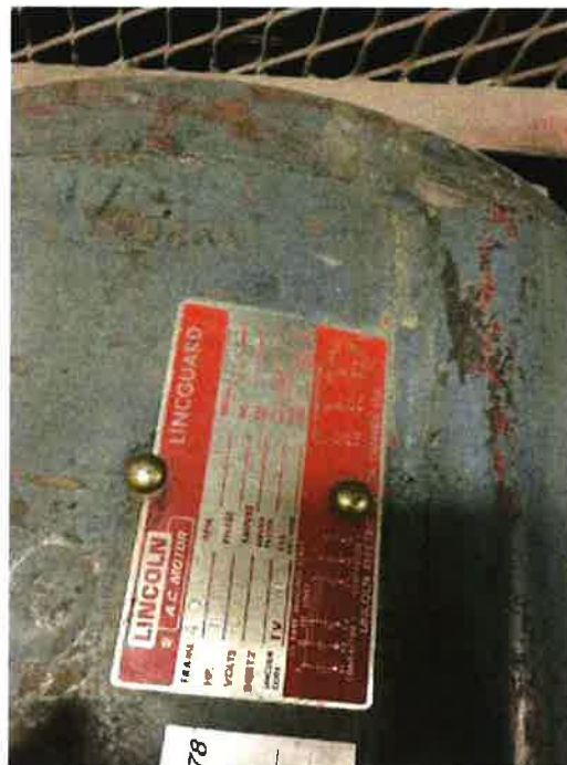
Photo 58: AHU1 supply fan motor tag
