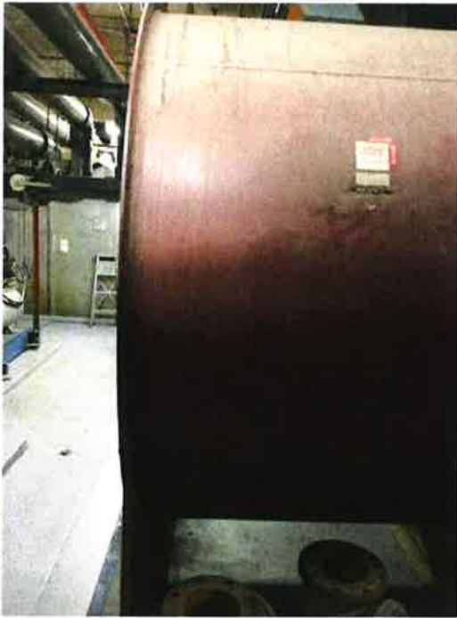
Photo 55: Open end of return fan
