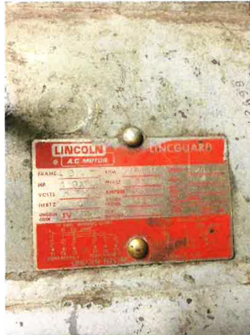
Photo 28: AHU fan motor tag, 100 hp
