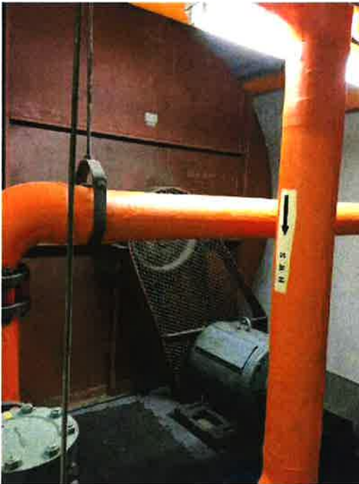
Photo 25: Air handling unit centrifugal fan
